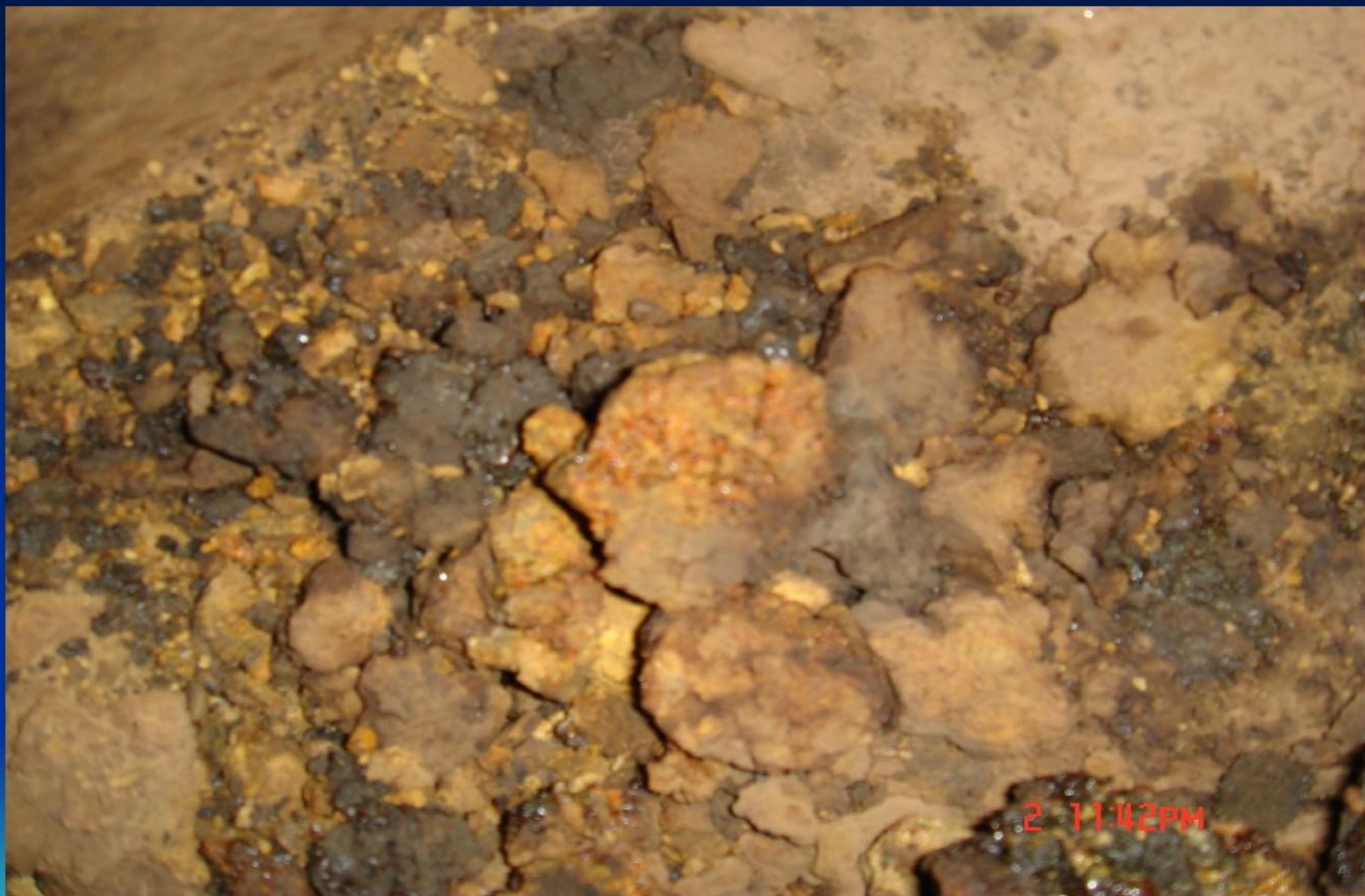
Завод Оргсинтеза (г.Казань), отложения кокса пирогаза в межтрубном пространстве ТА
